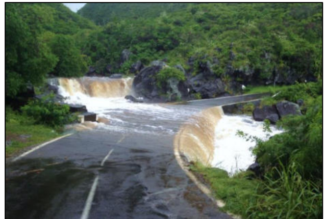
De fortes pluies y ont provoqué des inondations en mars 2015.
